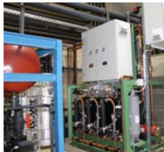
Optimierung der Kaltwasserversorgung: neue energieeffiziente Kältemaschine
