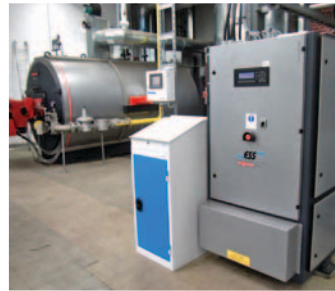
Abb. (v.l.n.r.): Freiluftkühlen Kälteanlage mit Freiluftkühler Energieeffizienter Brennwertkessel
