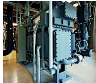
Abb. (v.l.n.r.): Tageslichtnutzung in der Fertigung, Blockheizkraftwerk, Absorptionskältemaschine
