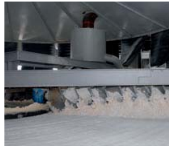
Abb. (v.l.n.r.): Außenansichten der Kalzinierung, Vorlagebehälter mit Aluminiumhydroxid
