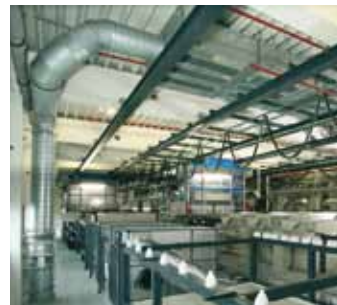
von links nach rechts: 50 kW Brennwert-Blockheizkraftwerk, Kompressorenabwärme zur Beheizung der Galvanik, über die Lüftungsanlage zugeführte Abwärme zur Beheizung der Wäscherei und Tauchgalvanik.
